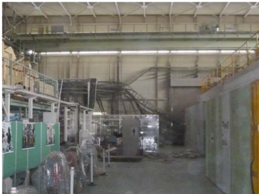
図 6 : 震災後の加速器棟内部。主動力ケーブルがラックごと崩落した。
