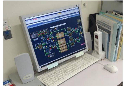
専用監視端末@制御室
