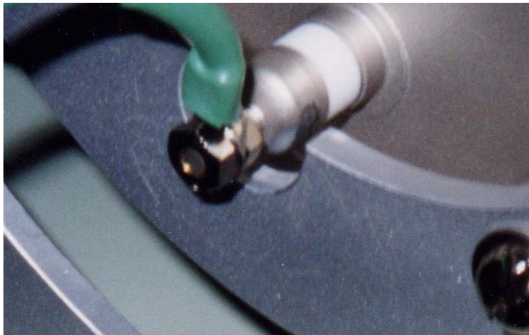
G1接続端子での放電痕
